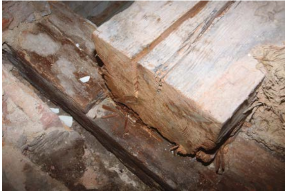
Bild 9: Nur im Auflager geschädigter, jedoch noch tragfähiger Balkenkopf
