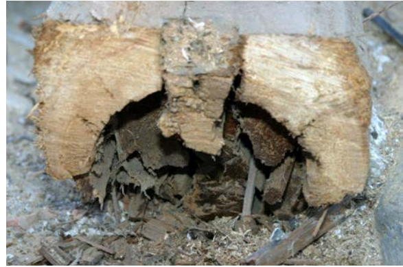
Bild 10: Starke Schäden am Balkenkopf, nicht mehr tragfähig
