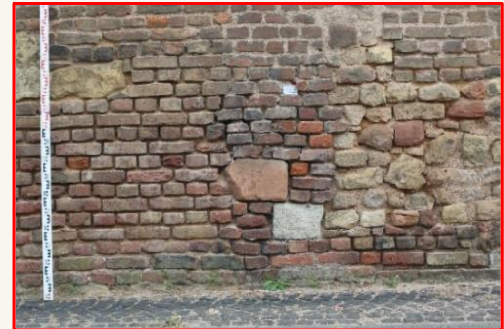
Abb. 2: Detailsicht Untersuchungsbereich straßenseitig (Aufnahme: Aurel Froitzheim, 2023)
