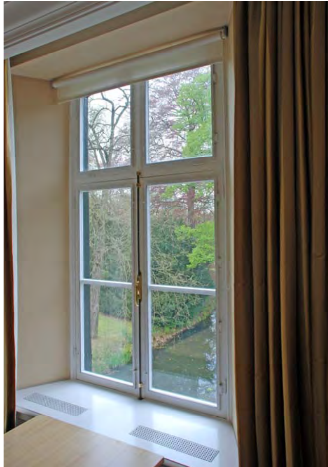
Figuur 6: Vrijwel niet zichtbaar: bij dit venster is achter elke glasplaat een plaat kunststof bevestigd aan het raamhout. [Bronvermelding] Foto: Taco Hermans
