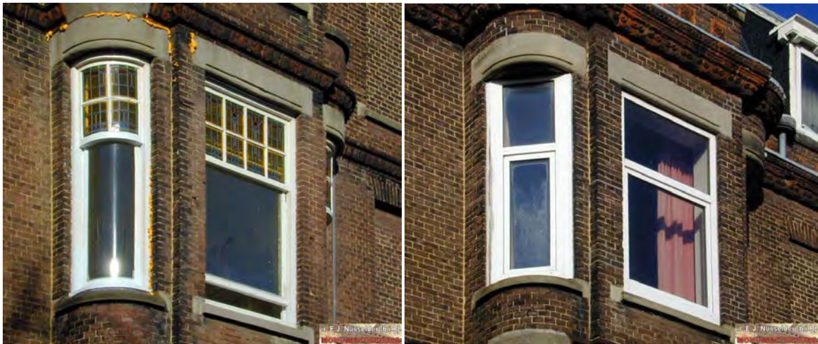
Figuur 1: Vervanging van enkel glas in een houten kozijn door dubbel glas in een kunststof kozijn. Verbeterd kozijn? Foto's: E.J. Nusselder
