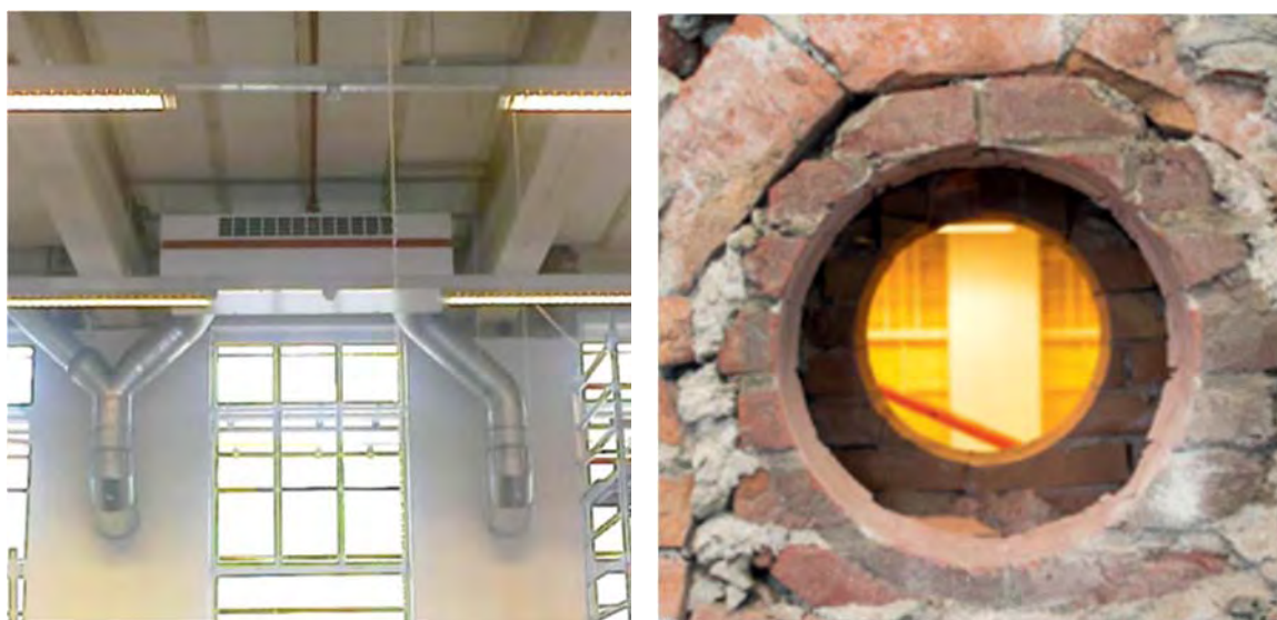
Fig. 5: Een fancoilunit in één van de onderwijsruimtes, een doorvoer voor de fancoilunit door een oude 'zuurkastopening'.
