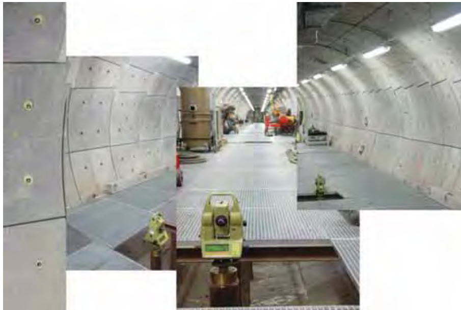
Fig. 3: SCK-CEN Mol: semi-automatische monitoring van de diameter van de ondergrondse galerij waar testen plaatsvinden voor ondergronds opslag van radioactief afval. Eveneens monitoring van een testzone waar temperatuur en drukverhogingen gesimuleerd worden om het gedrag van de galerij te bepalen.
