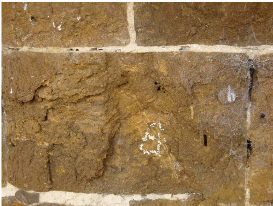
Figuur 4: Sterk verweerde steenblok
