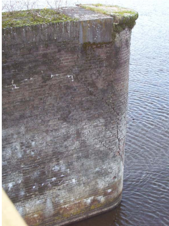
Figuur 2: Scheurvorming in één van de pijlers
