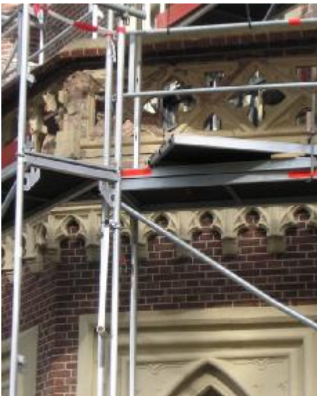
Figuur 11: Detail Huis De Schaffelaar. Tussen het steigerwerk door is te zien dat de balustrade een kern bevat van metselwerk. Daaroverheen is een pleisterlaag aangebracht
