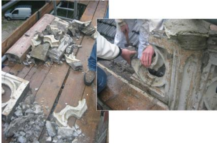
Figuur 18: Het uiteenvallen van de traceringen onder de afdeklijst van de balustrade
