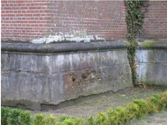
Degradatie van de plint door inwatering en zoutuitbloei
