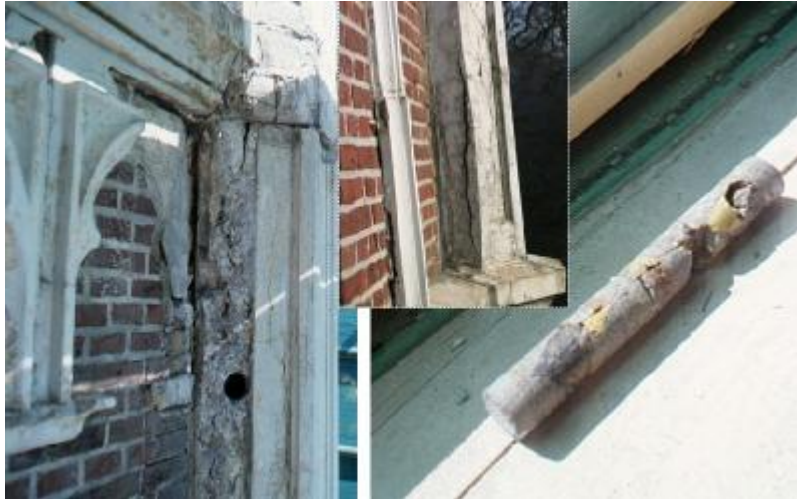
Figuur 15: Schade aan de arkels. Zichtbaar is de opbouw en de slijting van de arkels
