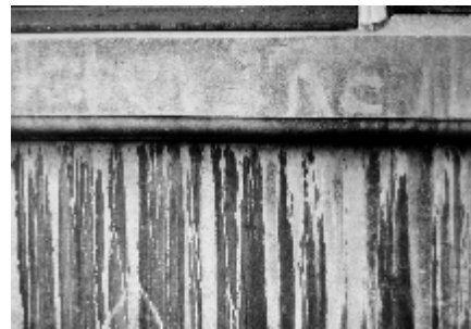
Fig. 15. Onzorgvuldig verwijderen van graffiti, waarbij met dunvloeibare oplosmiddelen is gewerkt zonder het ondergelegen geveldeel af te schermen, zorgt voor een sterke visuele verstoring van het natuursteen © RDMZ, M. v. Hunen.
