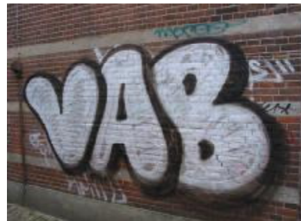
Fig. 2. Door graffiti visueel beschadigde gevel. © Utrecht, Sectie monumenten
