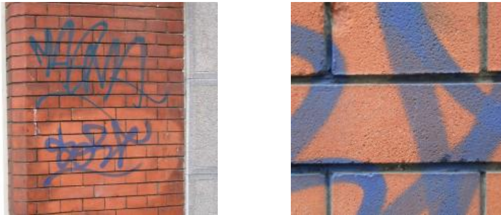
Fig. 10. Op de plek waar eerder graffiti is verwijderd is de nieuwe graffiti dieper in de ondergrond ingedrongen. © RDMZ, M. v. Hunen Fig. 11. Door het gebruik van een verkeerde reinigingstechniek is het oppervlak van de verblendsteen open en ruw geworden. © RDMZ, M. v. Hunen
