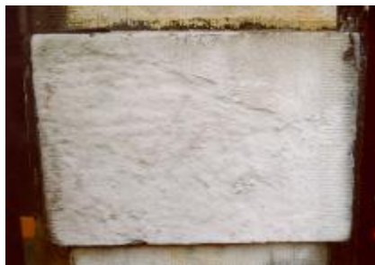
Fig. 3. Een door graffiti-removal fysiek beschadigde ondergrond. © RDMZ, M. v. Hunen
