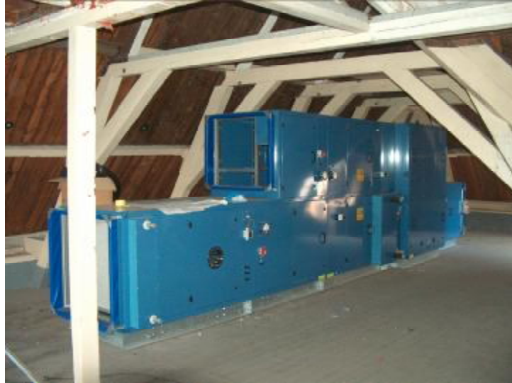
Fig. 2: Luchtbehandelingkast in aanleg voor de klimatisering van een museum in een monumentaal gebouw.
