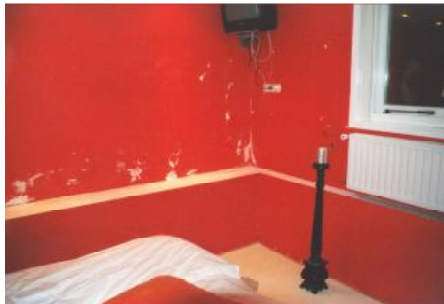
Afb. 12: Slapen in een klamme kelder met vochtproblemen
