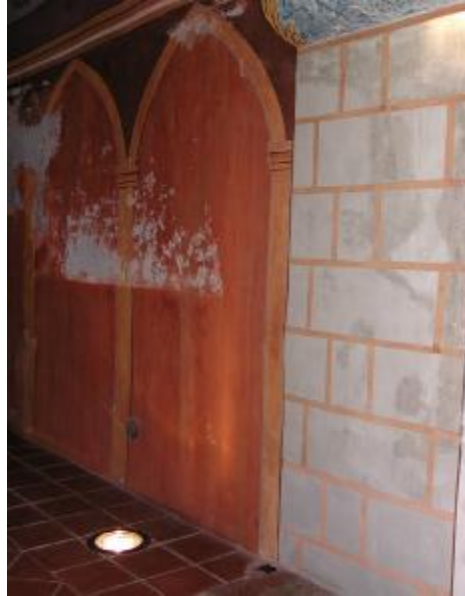
Fig. 8: Problemen veroorzaakt door het aanbrengen van een betere pleister voor de zoutbelaste ondergrond: schade ontstaat in de bovengelegen oude pleister (wordt dus door de nieuwe als het ware naar boven verplaatst)
