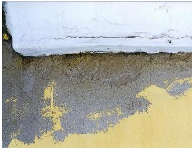
Fig. 9: Schade bij het raakvlak tussen nieuwe (onder) en bestaande (boven) pleister
