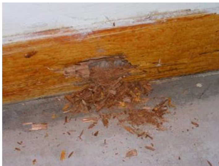
Afb. 1: Ten gevolge van vochtbelasting aan de achterzijde aangetaste houten plint
