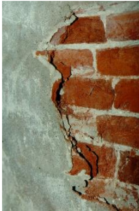
Fig. 1: Schade aan pleister en baksteen in een buitenmuur van een windmolen. Het schadetype kan worden omschreven als 'exfoliation' (afbladderen), en is ontstaan door de combinatie van zout- en vorstschademechanismen.
