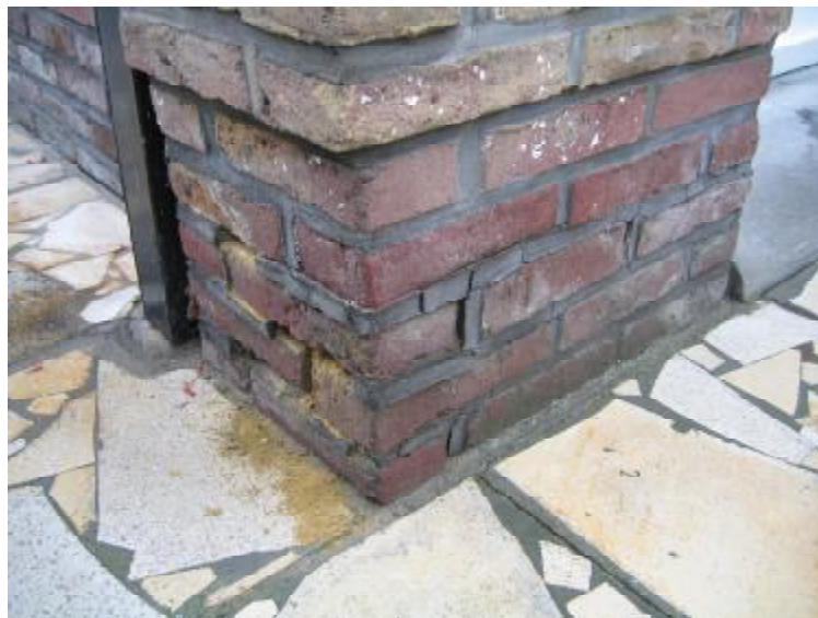
Fig. 6 : Vorstschade aan nat metselwerk, dat zich in dit geval vooral uit in het uitstoten van de voegen
