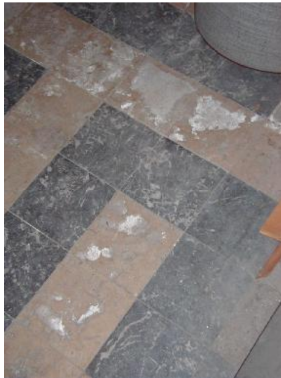
Fig. 5: Gipsvorming bij een kalkstenen vloer, door bevochtiging vanuit de ondergrond
