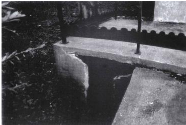
Fig. 9: Bezwijken van een wand onder de druk van het binnenstromende water (1991)
