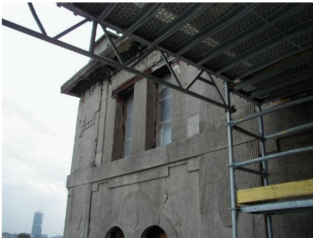
Figuur 5: Gescheurde gevels van de voormalige brouwerij Wielemans-Ceuppens te Vorst. De aard van het gebouw dringt in elk geval waakzaamheid, en misschien ook wel onderhoud op, reeds tijdens de restauratiewerken zelf. De situatie wordt in dit geval trouwens nog verergerd omdat ook de binnengevels gecementeerd zijn.
