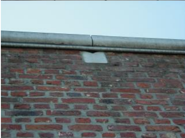
Fig 9.2 (Gevangenismuur, Leuven). Onder elke voeg in de dekstenen is een geultje in blauwe hardsteen aangebracht: risico op technische vervolgschade is sterk gereduceerd, risico op esthetische schade is groot (getuige de loopsporen en de algengroei). Risicoscore 8
