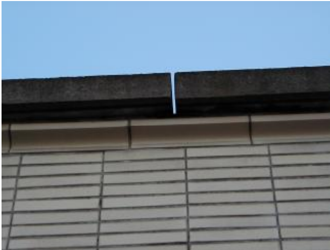
Fig. 9.1 (COOVI, Anderlecht). De dekstenen zijn met mortel geplaatst op het metselwerk. Elke ontbrekende of gescheurde voeg tussen de dekstenen geeft aanleiding tot veel infiltratie: risico op technische vervolgschade én esthetische schade is zeer groot. Met aanbrenging van een onzichtbaar membraan kan dat risico sterk gereduceerd worden. Maar in de situatie zoals de muur nu is: risicoscore 16
