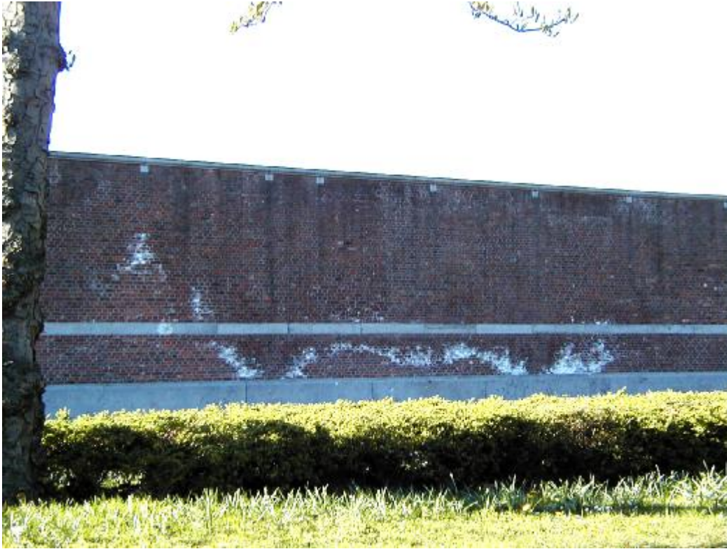
Figuur 10: Opname van het gehele geveloppervlak van de muur uit figuur 9.2 de ontwikkeling van algen, vorming van lopers én zoutuitbloeiingen is wel zeer opvallend.
