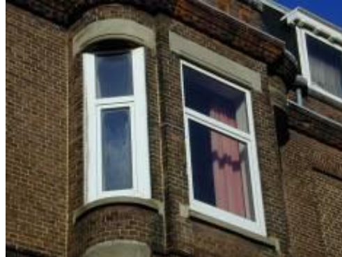
Resultaat van de ingreep is op de bovenste verdieping al te zien: oude ramen vervangen in PVC; eigenaar blij, maar het monument – de ‘andere klant’ van de monumentenzorger – huilt.
