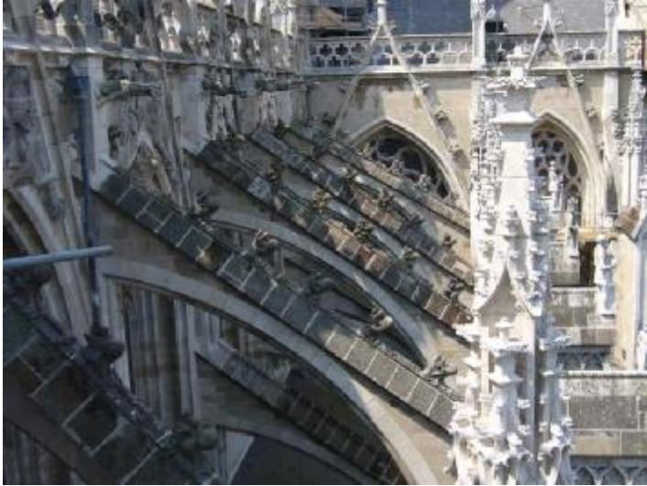
Figuur 3: Gezicht op de luchtbogen aan de noordzijde van het koor; een deel van de oostgevel van de noordelijke transeptarm is zichtbaar (foto Rob van Hees, 2006)
