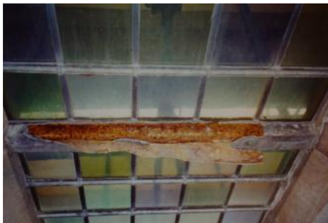
Figuur 16: Gescheurd lood en verroeste brugstaaf bij een venster van de Prinsenkapel (Foto: Architectenburo J. van Stigt bv., 1995)
