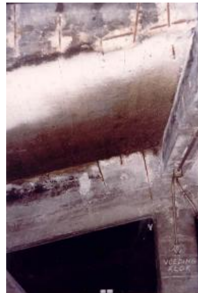
Fig. 7: Betonaantasting dakplaat + spant
