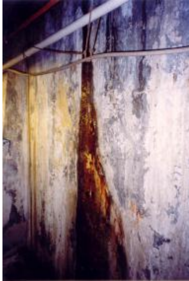
Fig. 1: Roestvorming + betonaantasting wand kuip
