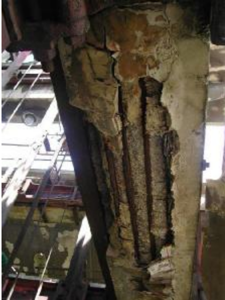
Foto 1: De wapening aan de onderkant van de balk is roestig en drukt schellen beton weg.
