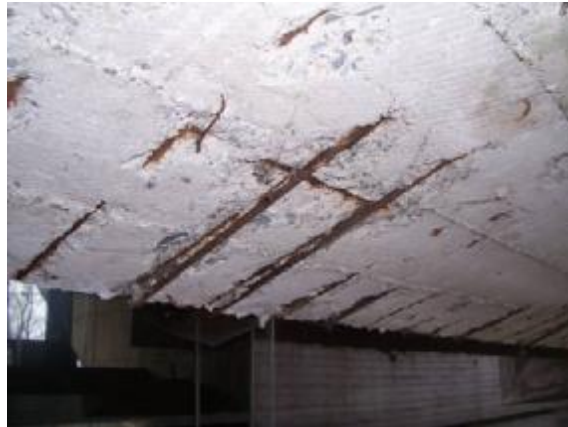
Foto 3: Roestige wapening onderaan een betonnen dakplaat
