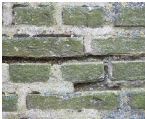
Figuur 1b: Onvakkundig voegherstel
