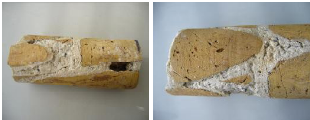
Figuur 11: Uitloging van kalk uit een metselmortel.
