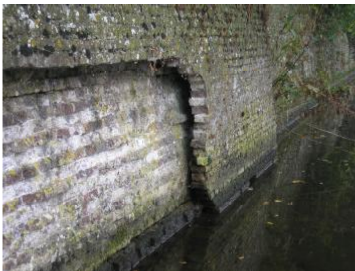
Figuur 19: Bastion katten, noordelijke face. Door bevroering is het muurwerk over een halve steen afgeboerd. Het afgeboerde metselwerk links lijkt zich al enige decennia goed te houden; reden om hier niet in te grijpen. Wel zullen de uitkragende stenen boven dit muurvlak worden verankerd, opdat zij bij bevroering niet afgedrukt worden. Het afgeboerde metselwerk zal, waar mogelijk met mortelinjectie gerestaureerd worden. Indien het verval, vooral vanwege beworteling, te groot is zal het muurschild worden weggenomen en opnieuw vertand opgemetseld worden.
