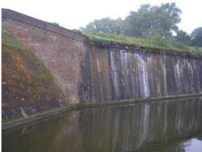
Figuur 9: Noordelijke flank van Oranje bij de saillant. Beeld van het muurwerk dat in 1980 geheel gerestaureerd is, waar vocht over de muur, onder de muurkroon en op diverse plaatsen uit het muurwerk stroomt en daardoor uitbloei van zouten veroorzaakt
