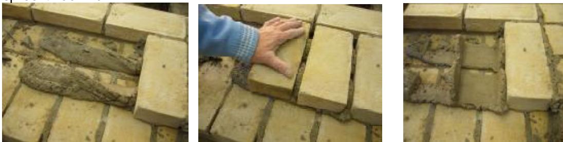
Figuur 10: Het ontstaan van holten in metselwerk door onvakkundige uitvoering: het aanbrengen van de metselmortel in stroken leidt tot holten in het metselwerk
