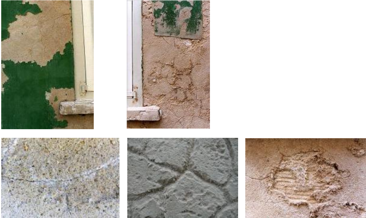
Figuur 15: Curaçao (NA) – Schadeontwikkeling aan een restauratiepleister op een zoutbelaste ondergrond, binnen een tijdsbestek van twee jaar na de applicatie. Nb kleurverschillen zijn een gevolg van het gebruik van verschillende camera's.
