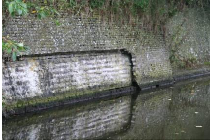
Figuur 7: Bastion Katten te Naarden: afboeren van een schil metselwerk, als gevolg van een goede hechting tussen strekken en koppen.
