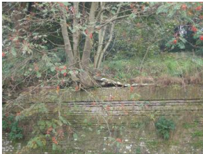
Figuur 13: Aanzicht van de courtine Oud-Molen-Katten. Dit gevreesde beeld van bomen die muurwerk ontwrichten is ontstaan door het iets afschuiven van de betonafdekking waardoor een zaailing zich kon nestelen. De wortels van deze boom hebben de betonafdekking opgetild. Frappant was dat bij een controlegraving de wortels achter de muur geen schade aan het metselwerk bleken te hebben aangericht.
