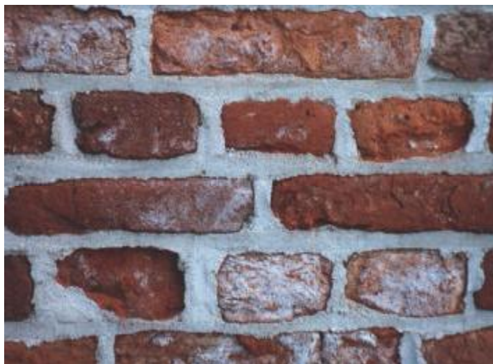
Figuur 4: Stadhuis Eeklo, zoutshade en verlies van oppervlaktemateriaal na waterwerende behandeling.
