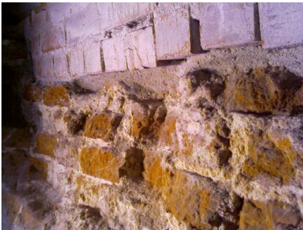
Figuur 5: Typische schade in het metselwerk van de Aula Magna te Brussel – heel gelijkaardig aan hetgeen men in zovele kelders kan waarnemen.
