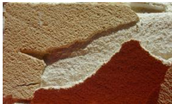
Figuur 7B: schade aan gehydrofobeerde oölitische kalksteen gecontamineerd met natriumsulfaat dat kristalliseert achter de waterwerende laag die hierdoor wordt afgestoten.
