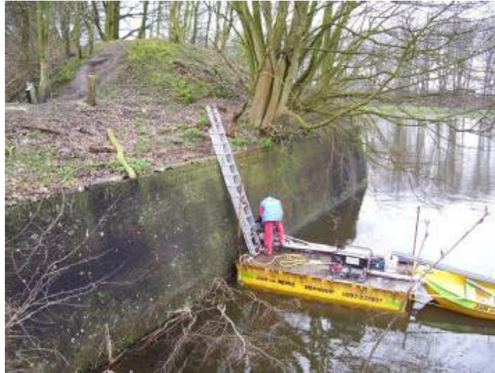
Figuur 14: Oostelijke face van Bastion Katten, tijdens het boren van boorkernen. Bovenop de muur staat een wortelstomp van ca 130 jaar oud, die minimaal twee keer is teruggezet. De uitschieters zijn a 40 jaar oud. Frappant is dat het muurwerk eronder in goede (droge) staat verkeert: de wortels van de boom dringen niet in het muurwerk maar zoeken hun vocht boven en vooral achter de muur. (Foto: Architectenbureau Van Hoogevest).
