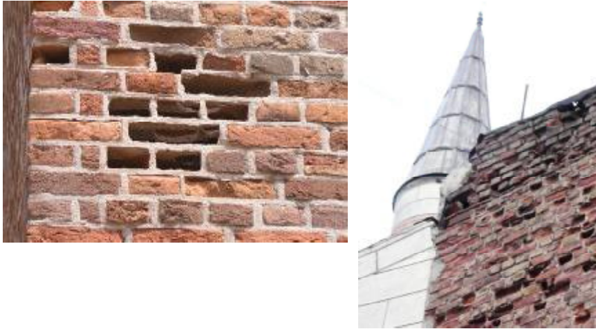
Figuur 7: Weg-geërodeerde stenen. Links: in een toren dicht bij de Noordzee; rechts: in een muur aan de Bosporus.
