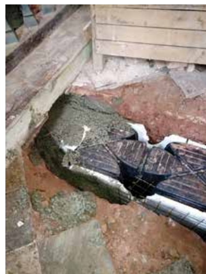
Obrázek 9: Větrací kanál s revizním přístupem, foto Bartakovics Jan
