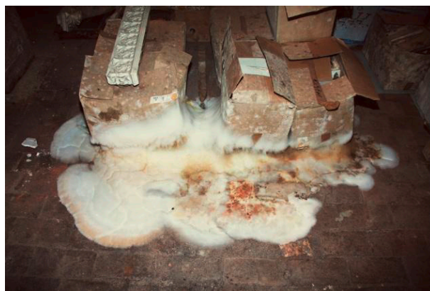
Bild 1 Hausschwammbefall an Lagergut im Keller
